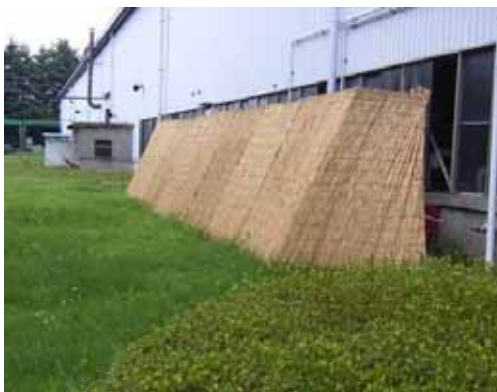
空調機屋外機の直射日光遮へい
