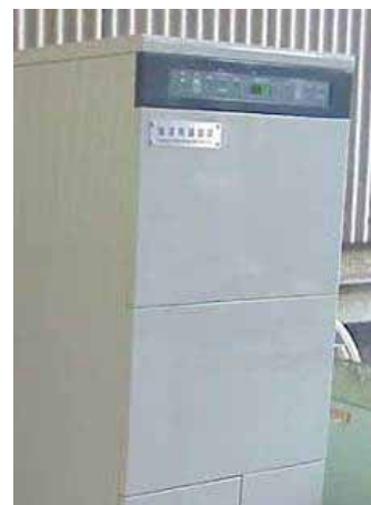
北本工場 機械加工切削水廃液の濃縮装置
