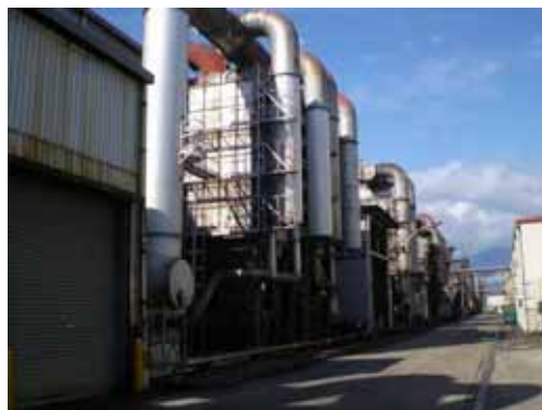
第1鋳造工場屋外集塵機群
