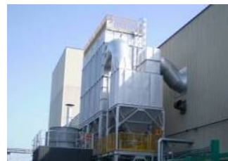
鑄造工場への集塵機増設
